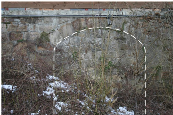
Heute: Zugemauerter früherer Zugang
