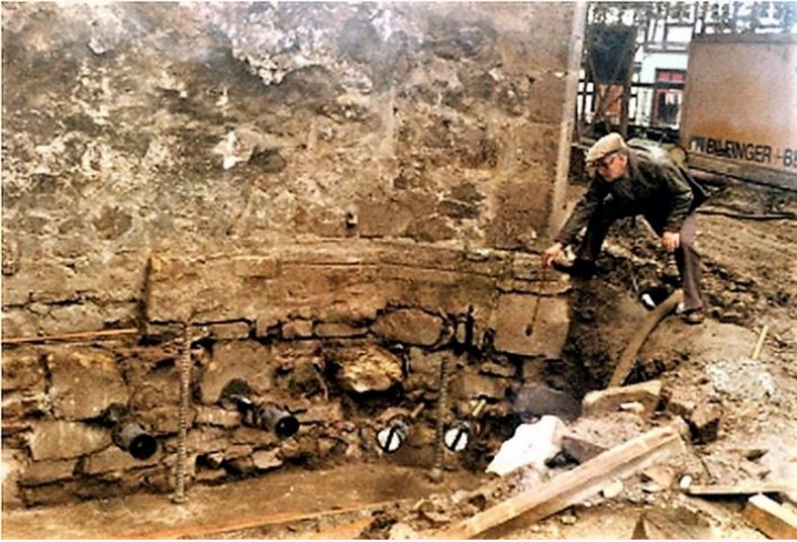
Grundfundamente in einem sehr schlechten Zustand
